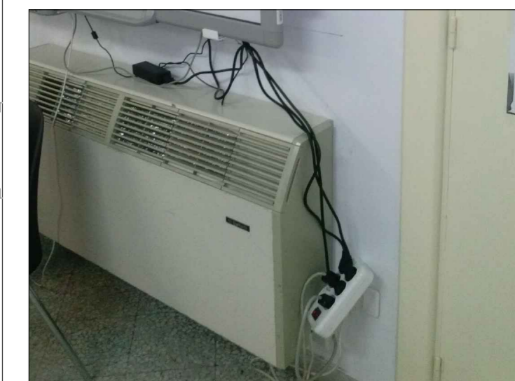
AZIONE C 2 - 1 Foto 2 - Impianti elettrici
